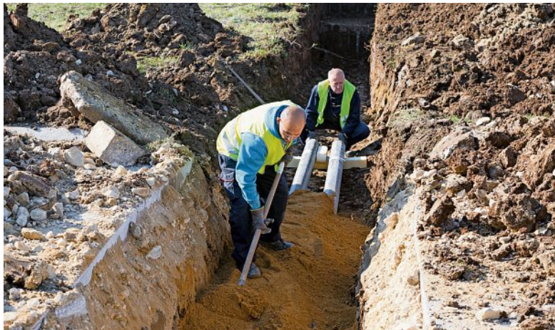
Le creusement d'une canalisation peut être imposé dans un bien-fonds privé qui n'en bénéficie pas directement. GETTY IMAGES
